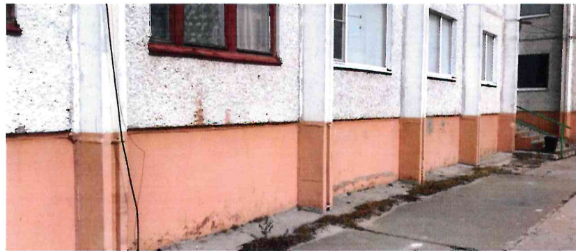
Фото №28. Фасад по оси 5-5/П-К.
