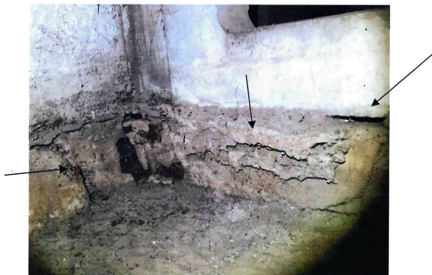
Фото №38. Следы перерыва бетонирования и развалов опалубки при строительстве.
