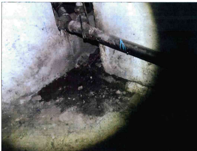
Фото №45. Капельные течи на момент обследования.
